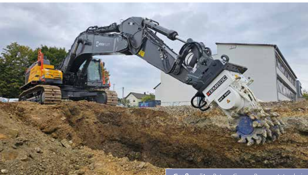
Großgerät: Peter Gross Bau nutzte bei Erschließungsarbeiten in Gärtringen einen 75 t-Bagger – eine sehr ungewöhnliche Maschinengröße im städtischen Infrastrukturbau. (Fotos: Kemroc)
