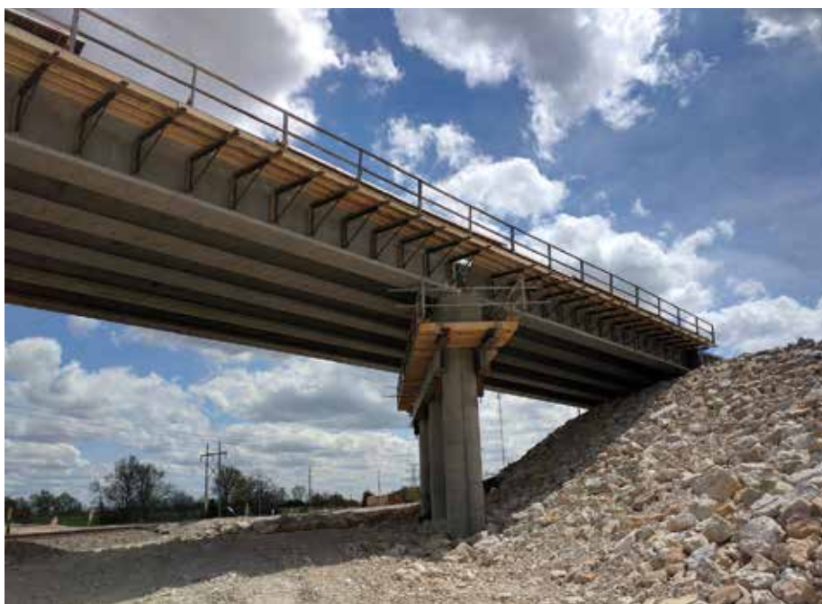
Positives Signal: Die Bauwirtschaft Baden-Württemberg e.V. begrüßt die Pläne von Landesverkehrsminister Winfried Hermann, 73 einsturzgefährdete Brücken bis 2030 zu ersetzen. (Foto: pixabay/gzu)
