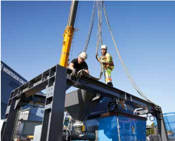
Alles im Werden: Aktuell wird mit Hochdruck am Aufbau der Messestände gearbeitet.
