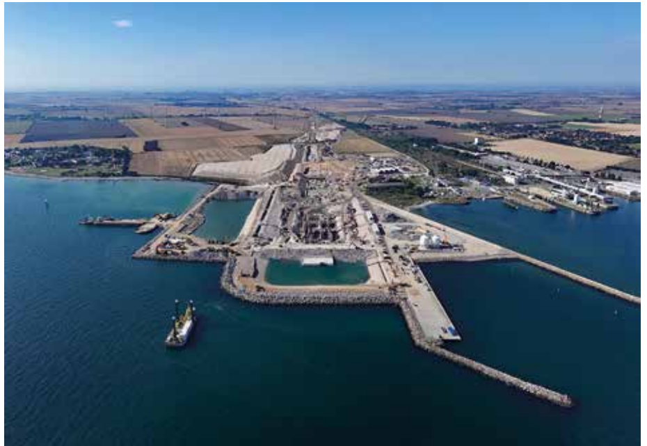
Logistische Meisterleistung: Das Tunnelportal Puttgarden auf deutscher Seite ist Teil des größten Infrastrukturprojekts Nordeuropas. (Foto: Femern AIS, Christian Hübner)
