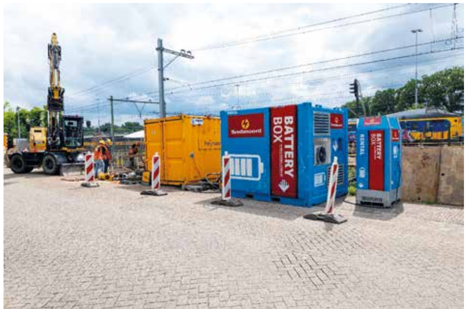
Gut gelöst: Zwei Bredenoord Batteriespeicher versorgen emissionsfrei Baucontainer und eine Bohranlage. (Foto: Bredenoord)
