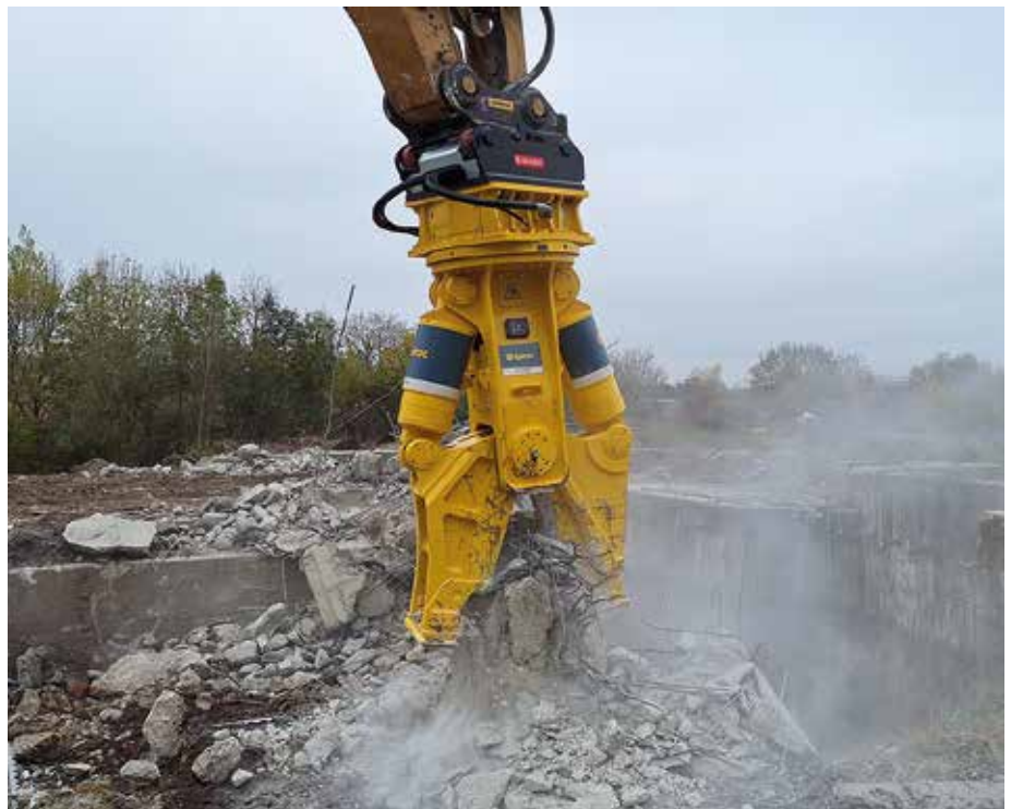
Schafft Platz: Die Kombi-Zange CC 3100 von Epiroc beim Rückbau des ehemaligen Heizhauses in Eisenberg. Hier soll später das Dienstleistungszentrum des Landratsamtes entstehen. (Foto: Epiroc)
